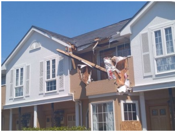
写真 3 飛来物による被害
