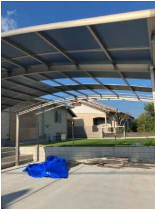
写真 24 カーポートの被害
