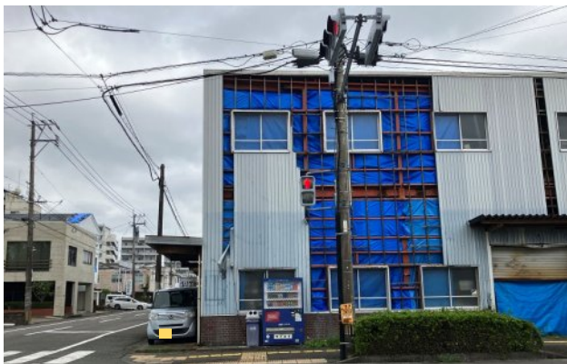
写真 14 壁面材の剥離
