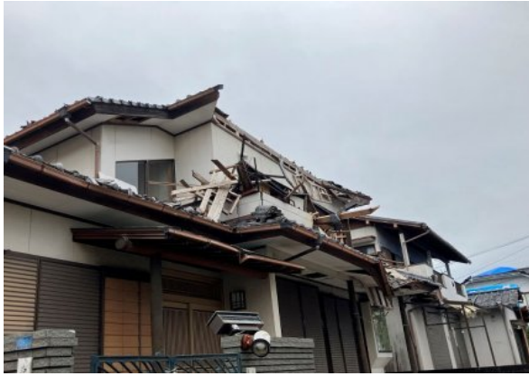
写真 9 飛来物を含む屋根被害
