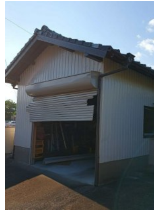
写真 26 シャッターの破損
