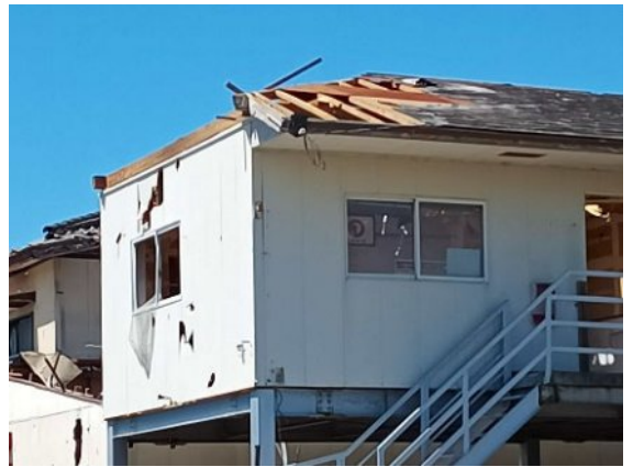
写真 4 開口部と屋根の被害
