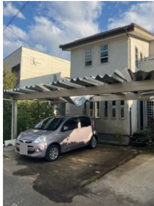
写真 25 カーポートの被害
