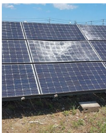
写真 22 ソーラーパネルの被害
