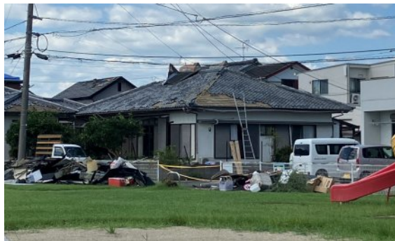
写真 5 瓦と太陽光温水器の被害
