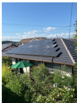
写真 18 屋根置ソーラーパネルの破損(飛来物)
