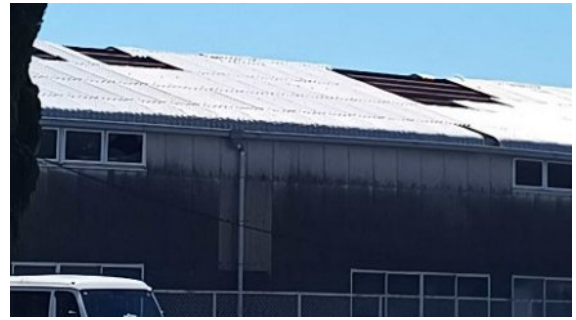
写真 2 倉庫屋根の被害
