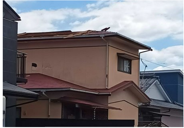
写真 10 屋根野地板の飛散
