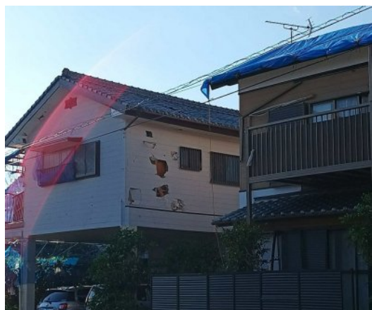
写真 21 屋根の被害にともなう壁面被害
