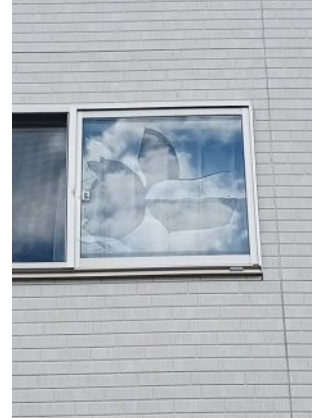
写真 13 窓ガラスの割れ
