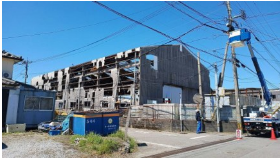
写真 1 倉庫壁面の被害
