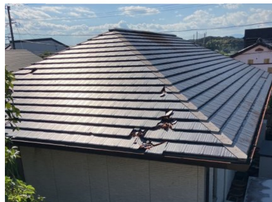
写真 17 飛来物による瓦の割れ
