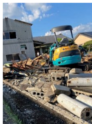
写真 20 倒壊した倉庫(近景)
